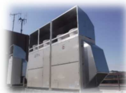
高効率空調設備室外機
