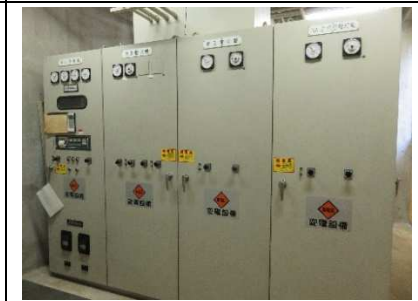
【中学校】耐用年数を超過して使用している受変電設備（経年 35 年）
