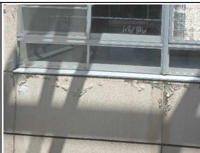
【小学校】外壁仕上げ材の剥離、ひび割れ（経年 26 年）
