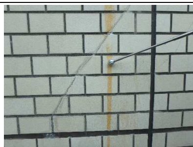
【第 2 特別教室棟】外壁タイルのひび割れ（経年 35 年）
