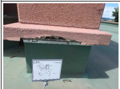
【学教センター】コンクリート劣化、屋上防水の劣化（経年 38 年）
