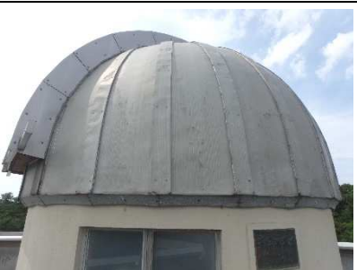
【中学校・天体観測室】劣化が著しい金属屋根（経年 56 年）
