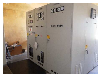
【学教センター】耐用年数を超えて使用している受変電設備（経年 38 年）
