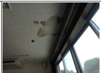
【第 2 特別教室棟】外壁のひび割れによる漏水跡（経年 35 年）
