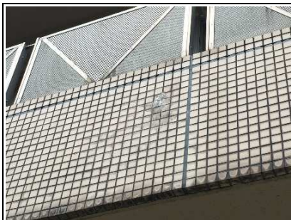
【小学校】外壁タイルの浮き（経年 26 年）
