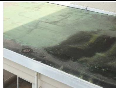
【中学校】老朽化している屋根防水（経年 19 年）
