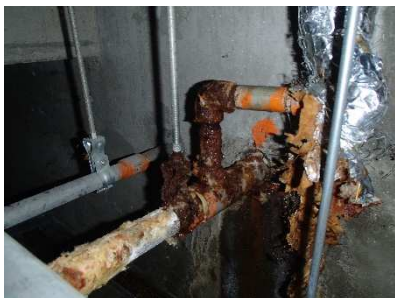
【大学会館】給水間の腐食による水漏れ (経年 41年)
