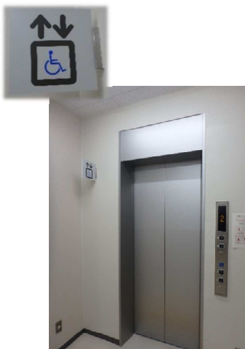
車イス対応エレベーター
