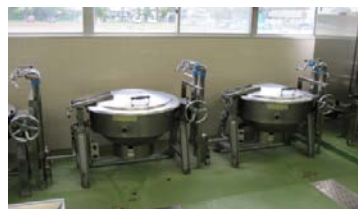
附属小学校給食用厨房設備
