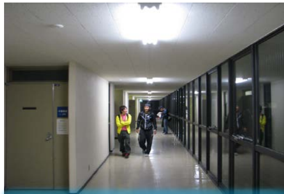
直管型LEDランプを取り付け、省エネに努めている廊下
